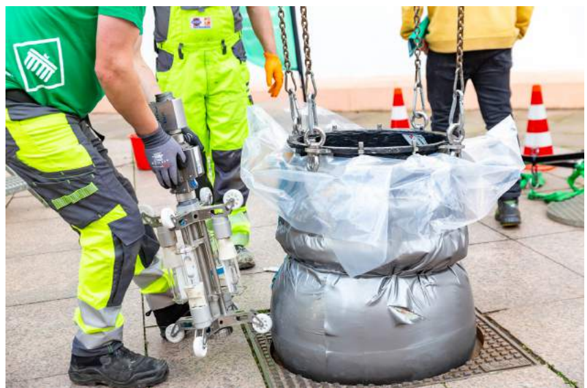
Installation d'un BB2.5 VERTICAL dans le cadre d'un chantier de démonstration à Ettlingen (Allemagne) sur une zone piétonne.
